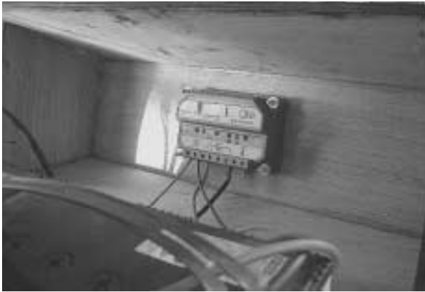
写真10 充放電コントローラー
