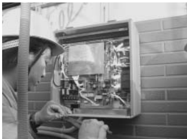
写真4 インバーター接続
