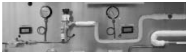
図6 膨張弁設置状況
