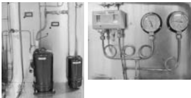
図4 圧縮機設置状況
