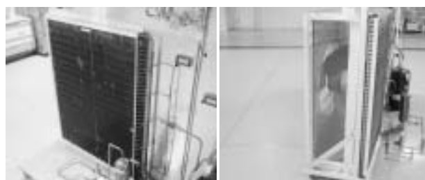
図5 凝縮器設置状況
