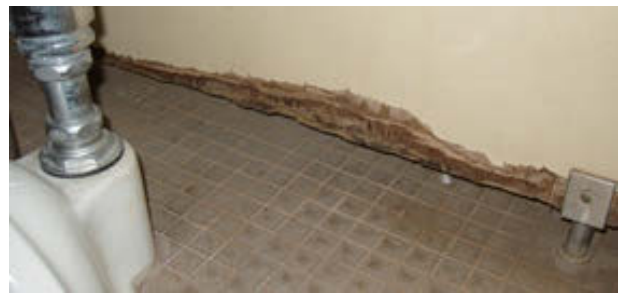
図4 ブース劣化状況
