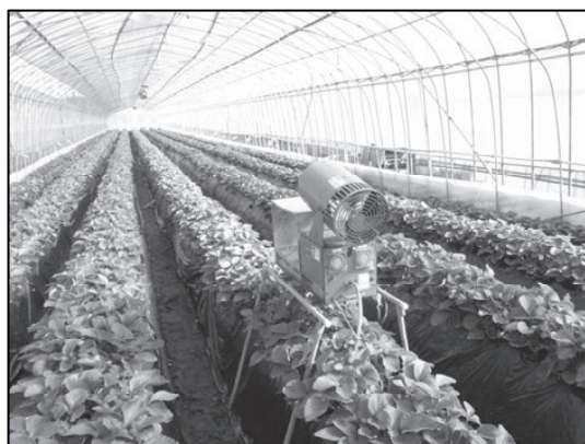
ハウス内のCO 2 濃度を高めるために設置されている装置。(写真提供:(有)ストロベリーフィールズ)
