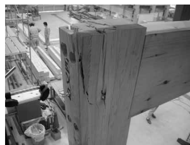
写真16 柱の引張割裂破壊
