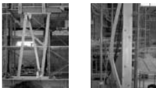
(a) 全体 (b) 筋かい破断部
