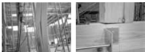
(a) 筋かい破断部 (b) 引張側柱の浮上り
