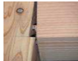
<写真6 差し鴨居引抜破壊>
