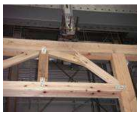
<写真2 筋かい座屈破壊>
