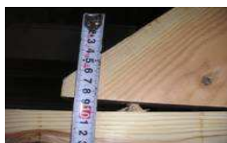
<写真4 補強材引抜破壊>
