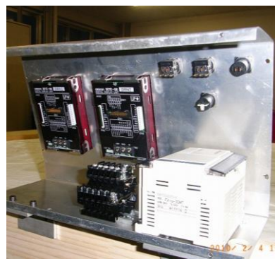
図8 制御盤内の部品配置 (配線前)
