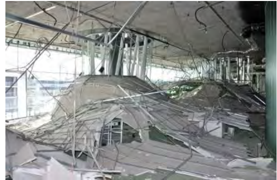
図 1 地震による天井落下被害 (2011.3.11, せんだいメディアテーク)
