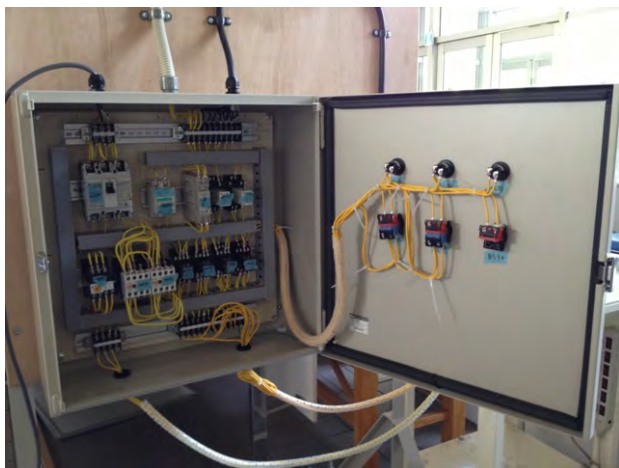
図3 制御盤本体配線
