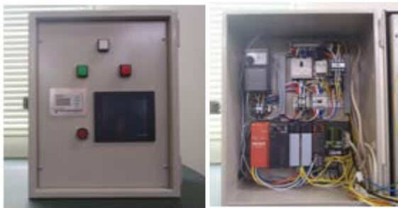
図 3-2 左 制御盤扉 右 制御盤内
